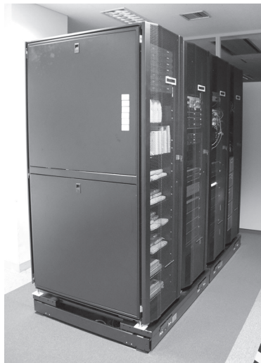
免震装置に載るサーバー
